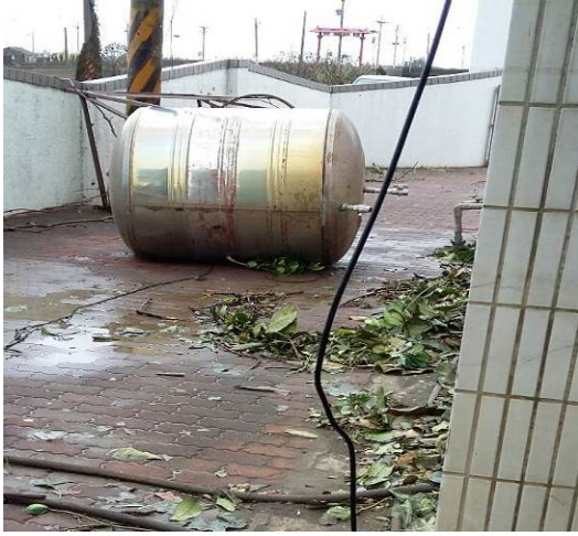
水塔遭吹落扯斷電線
